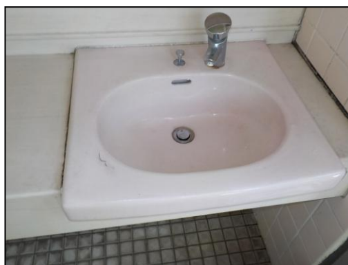
女子トイレ内手洗器
