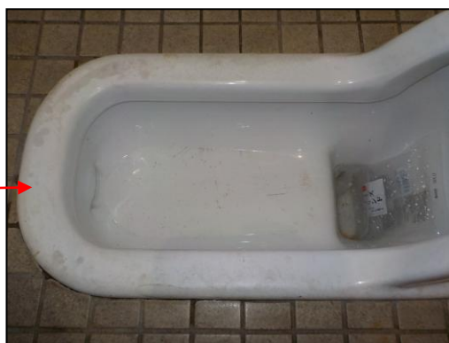
便器全体 水垢汚れ
