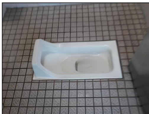
便器全体 水垢汚れ
