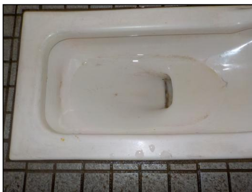
洗浄面 水垢汚れ
