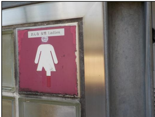
ピクトサインの剥がれ
