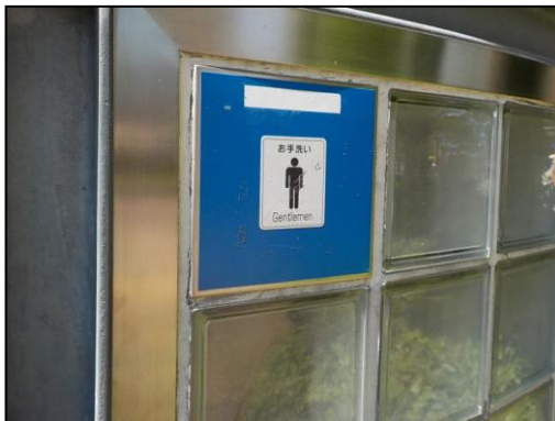
ピクトサインの剥がれ・汚れ
