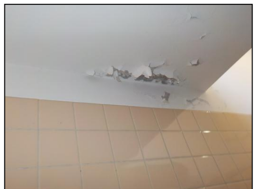
天井・壁面（ペンキの剥がれ）
