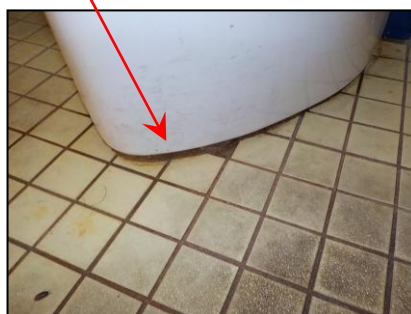
便器と床との隙間
